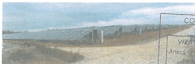
Parc fotovoltaic la Maruntisu
